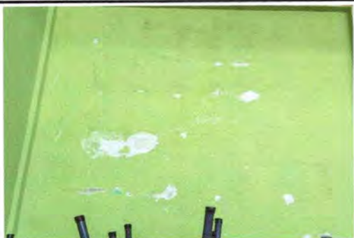
Foto 5: Cambio de pintura por deterioro.
